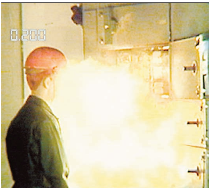
1a Acidente por Arco sem protecção
